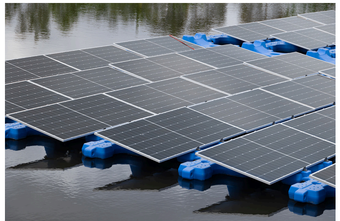
ระบบผลิตไฟฟ้าพลังงานแสงอาทิตย์แบบลอยน้ำ (floating solar)
