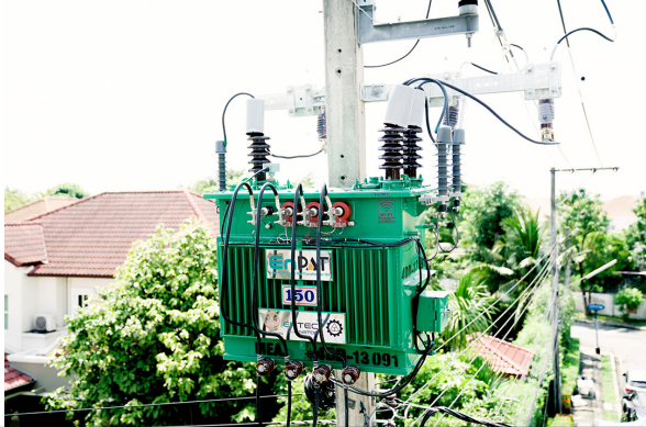
หม้อแปลงไฟฟ้า EnPAT ที่ติดตั้งใช้งานใน กทม.
