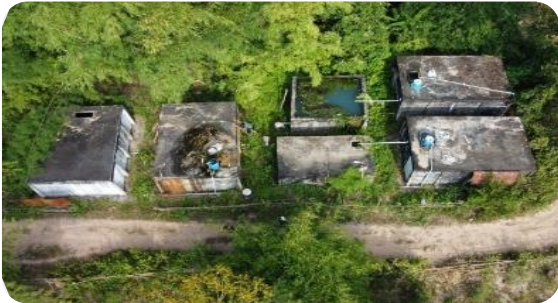
ระบบประปาภูเขาบ้านสันดอนแก้ว ก่อนปรับปรุง
