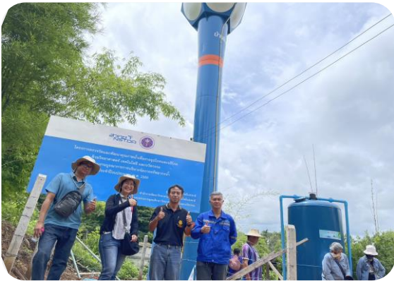
หอดักเหล็กและถังกรองคาร์บอนเพื่อแก้ปัญหา ด้านปริมาณและคุณภาพน้ำ บ้านสันดอนแก้ว หลังปรับปรุง
