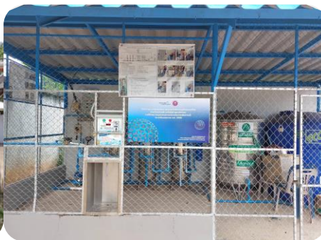
ระบบผลิตน้ำดื่มบ้านหนองบัวน้อย หลังปรับปรุง
