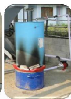
เตา ถังน้ำร้อน และปั๊ม
