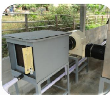
ชุดแลกเปลี่ยนความร้อน (หม้อน้ำและพัดลม)
