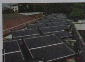
ระบบผลิตไฟฟ้าและน้ำร้อน ที่โรงพยาบาลบางละมุง
